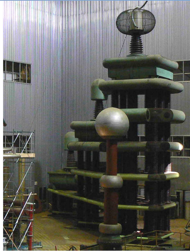
Каскадный трансформатор ИОМК 2250кВ
